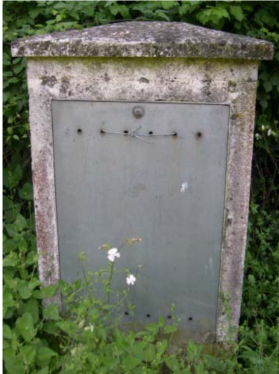
rigeneratori di linea HDB3 tecnica N1
