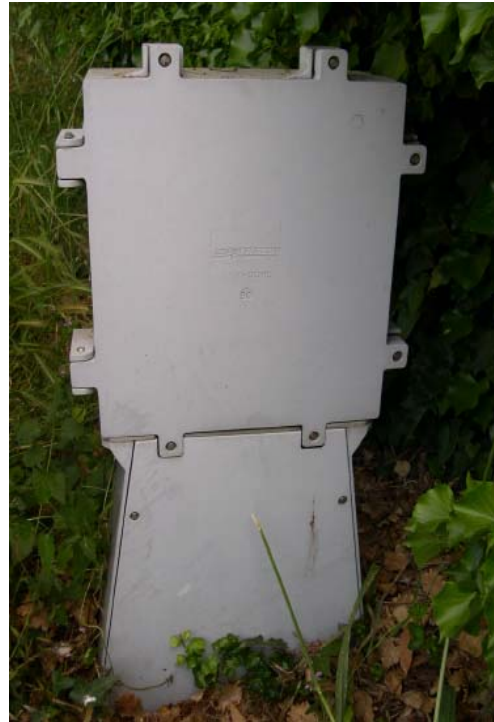
rigeneratori di linea HDB3 tecnica N2
